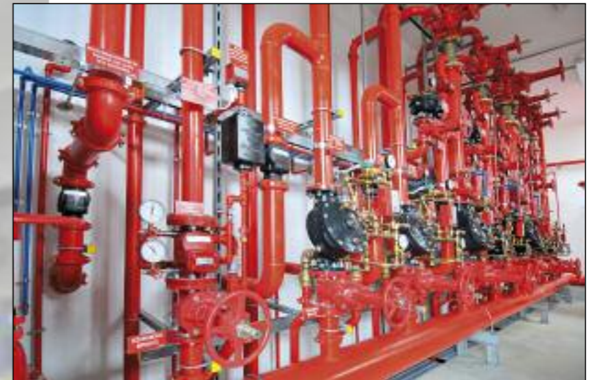
Particolare del collettore
